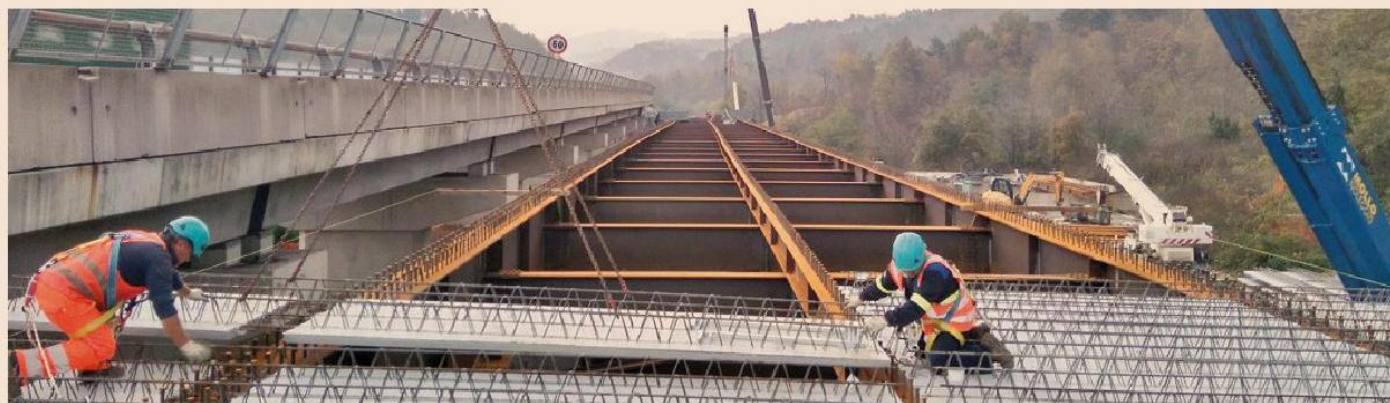
Al lavoro. I lavori sul viadotto Mollere lungo la Torino-Savona, l'autostrada con la più alta densità di ponti in Italia
